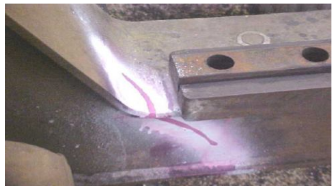
Figure 3 : Exemple de fissure détectée dans une traverse.
