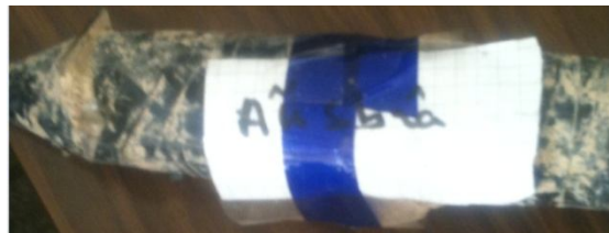
Figure 4 : Dégradation d'une boîte de jonction de la région d'Ain Sbaà [4].
