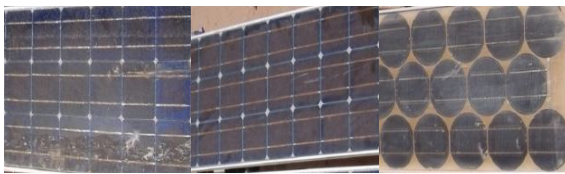
(a) Vitrage cassé (b) Décoloration des cellules (c) Jaunissement
